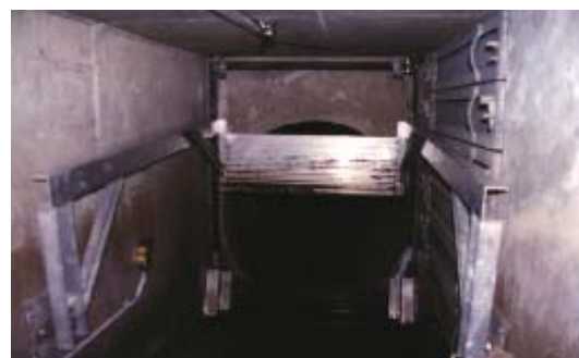
Vanne en position ouverte
