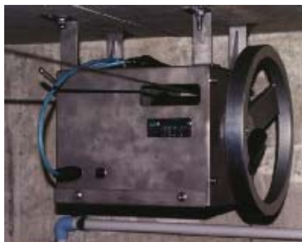
Boîte noire de commande de vanne (moteur frein)
