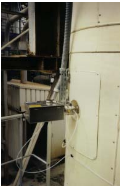
Récepteur OPSIS installation amont
